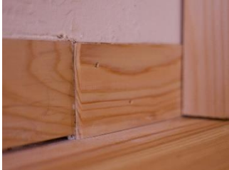
図 14 巾木の施工ミス
