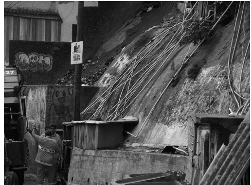
写真3: ファベラの水道。木のドアが付いた道沿いの箱の中にポンプがあり、これで水をくみ上げ、崖を無秩序に登るパイプで丘の上の家に配水している。 （筆者撮影）
